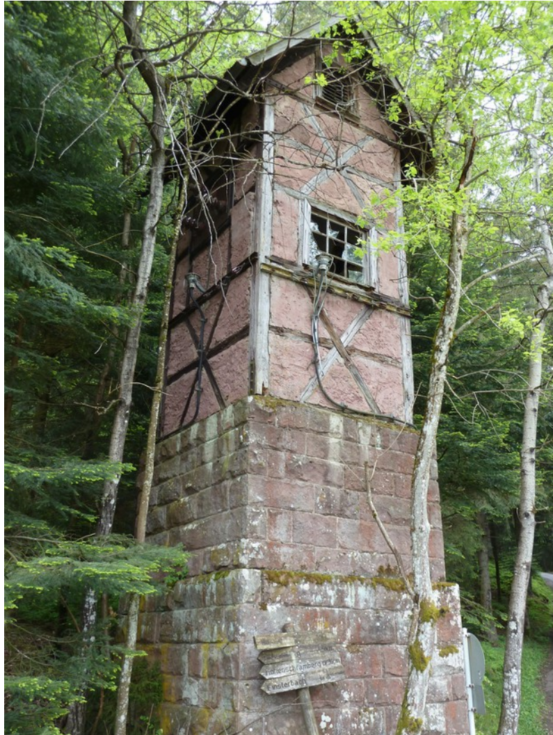
Die Transformatorstation beim Hinterholzer Hof.
